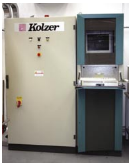
Fig. 11 - La centrale di controllo del reattore, dotata di PC, con software (ad interfaccia grafica) per l'impostazione e la memorizzazione dei diversi cicli messi a punto da Libra Elettronica per le diverse esigenze di rivestimento tecnico ed estetico su diversi materiali (plastici, metallici e vetro)
